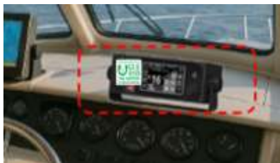
③安全設備全景写真
